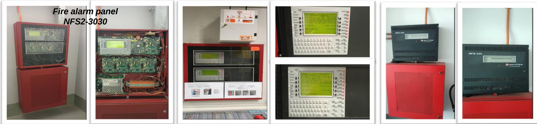
Fire alarm panel (Notifier) di Aras 18 Fire alarm panel (Notifier) di Aras GF di BCS Fire alarm panel (Notifier) di Aras 38
