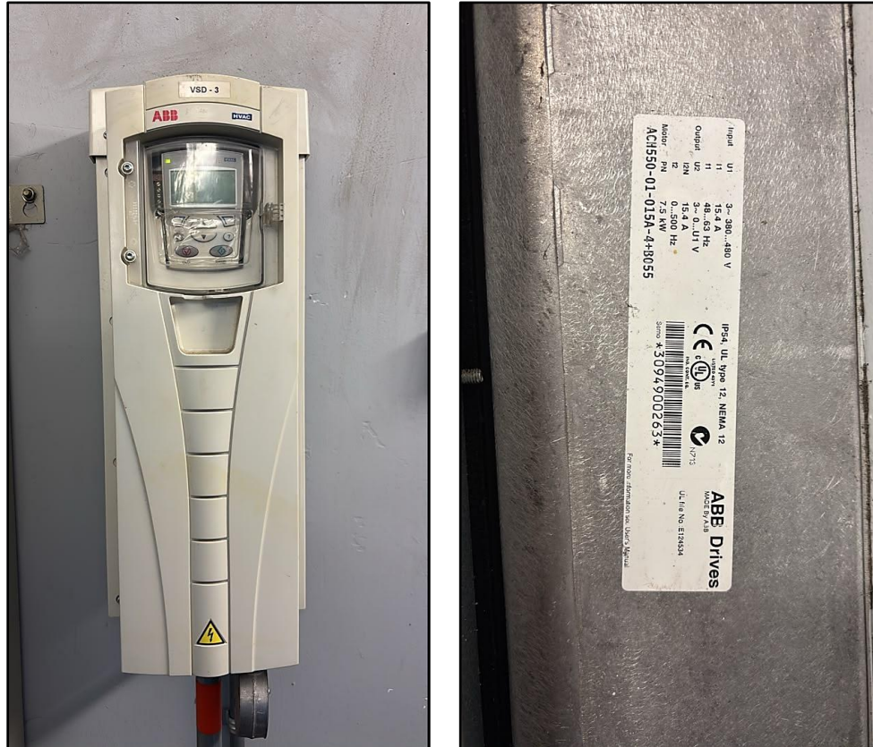
Peranti VSD berkuasa 7.5 kW yang telah usang ( obsolete ) di Bilik AHU 3, Aras 1
