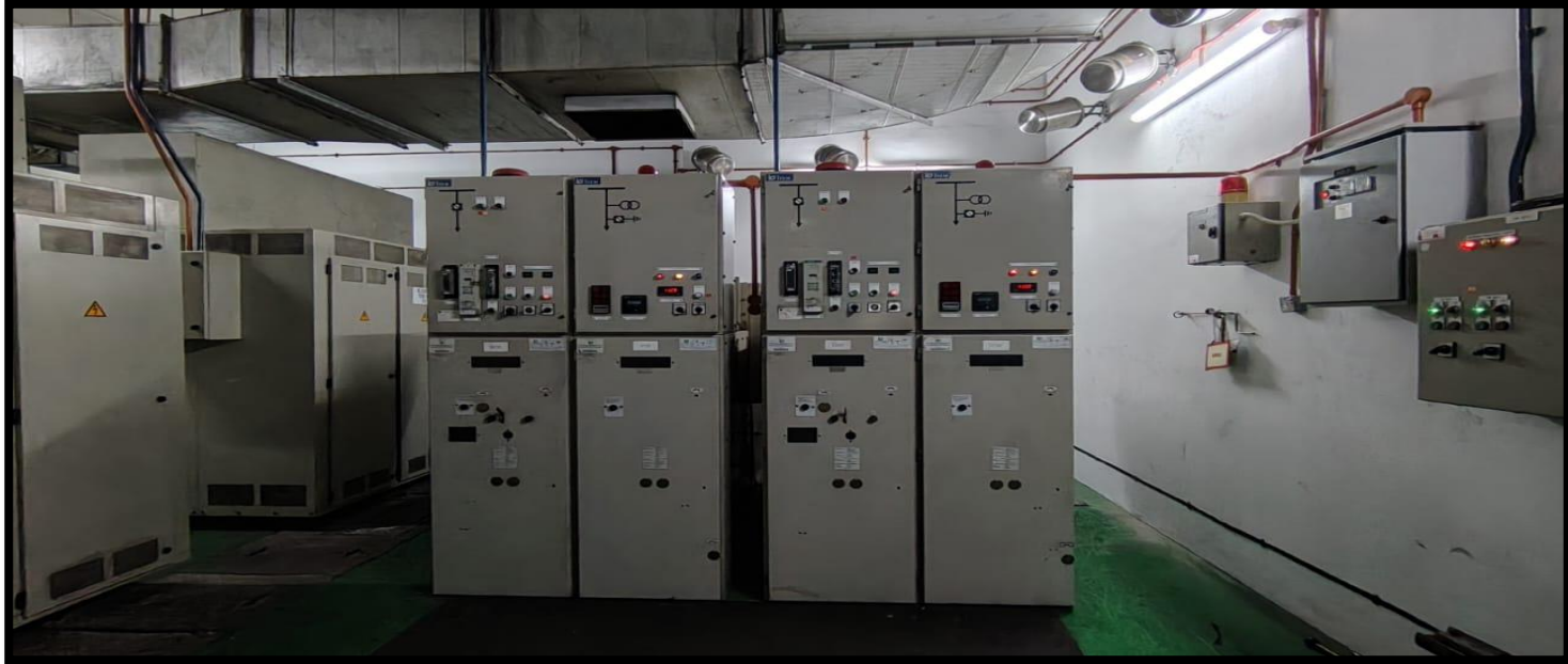
VCB PANEL 11KV DI BLOK SP4
