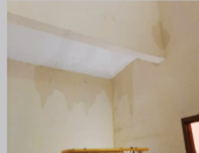
kesan basah pada lantai & dinding
