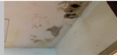
kebocoran pada siling
